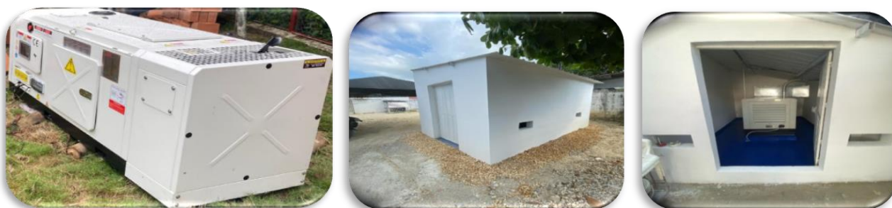
Gráfica 19. Plantas Eléctricas instaladas, con cabina insonora
